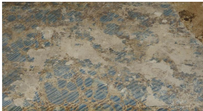
Fig. 18: Pérdida de soporte provocada por lepismas
