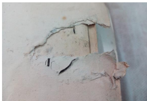
Fig. 20: Pérdida de soporte provocada por roedores
